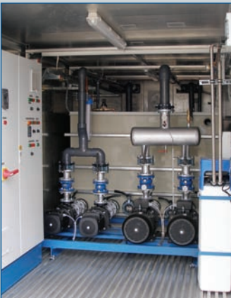
Pumpen-Tankanlage mit Steuerung
