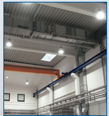
Produktionshallen-Klimaanlage mit Heiz-, Kühl- und Filterelementen
