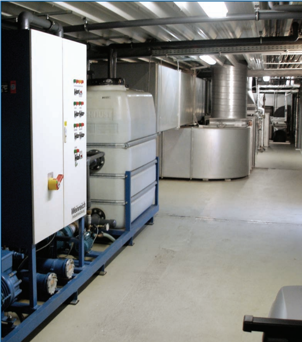
Reinraum-Klimaanlage mit 35.000 m 3 /h Luftvolumenstrom und Kompressor-Kühlmaschine
