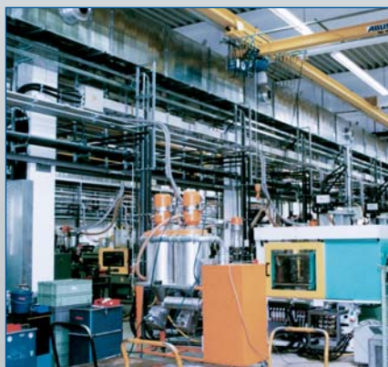
PVC-Verrohrung in einer Spritzerei
