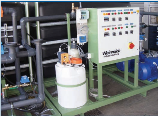
Impf- und Absalzanlage
