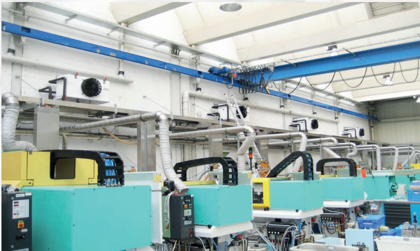
Hochleistungs-Luftkühler für Reinraum-Spritzerei
